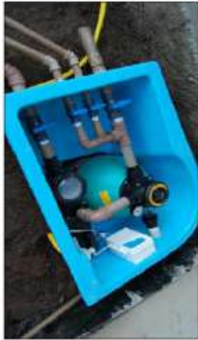
DETALHE FILTRO E MOTOR PISCINA
